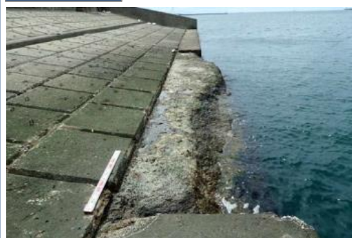
西護岸 ①上部工に欠損
