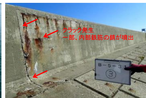
西護岸 ②擁壁にクラック発生
