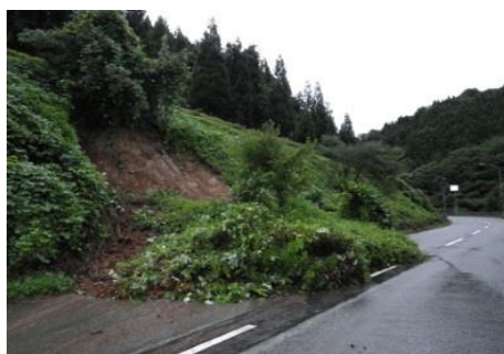
法面崩落による被災
