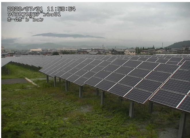
令和2年7月31日 12:00 太陽光発電所の状況
