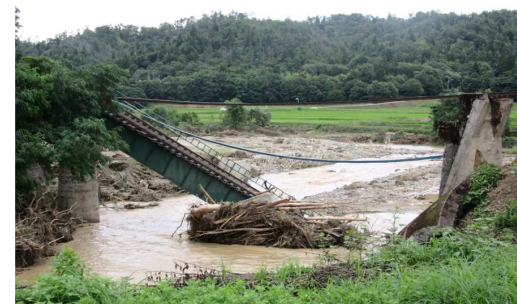
JR米坂線 小白川橋梁崩落(手ノ子駅～羽前椿駅)
