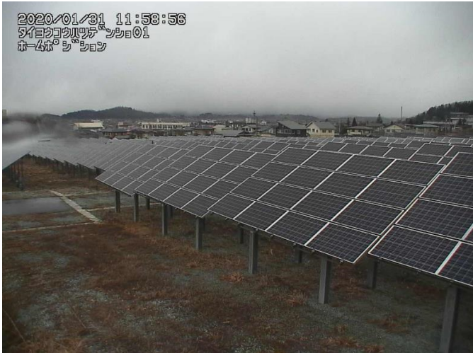
令和2年1月31日 12:00 太陽光発電所の状況
