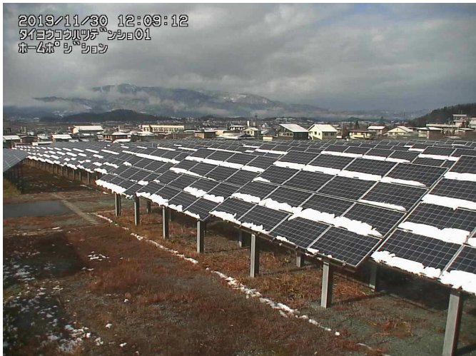
令和元年11月30日 12:00 太陽光発電所の状況
