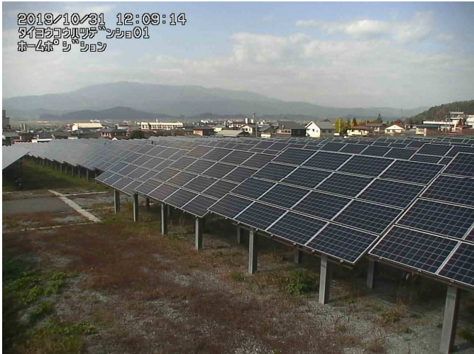
令和元年10月31日 12:00 太陽光発電所の状況
