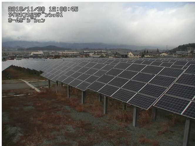
平成30年11月30日 12:00 太陽光発電所の状況
