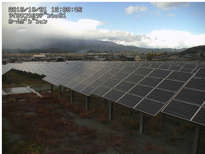
平成30年10月31日 12:00 太陽光発電所の状況
