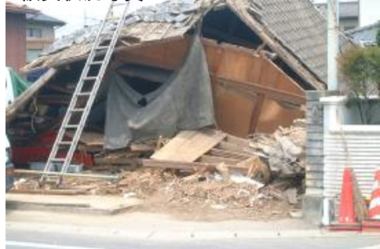
被災状況写真1
