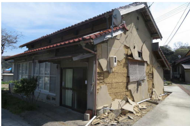
写真：被害状況（外壁剥落）
