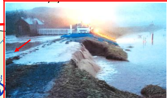
常呂川の堤防崩れ(北見市)
