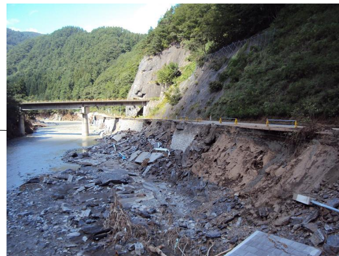
国道455号の道路被害状況(二升石地区)
