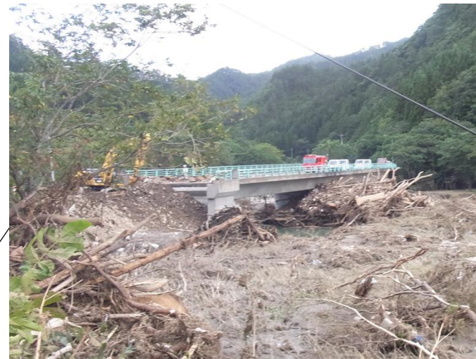
橋梁被害状況(乙茂地区)
