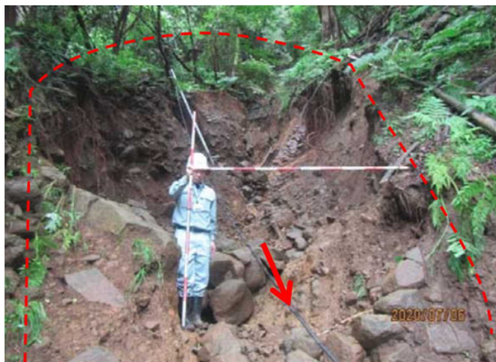
がけ崩れ発生状況
