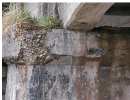
図-1.3 凍害による損傷事例
