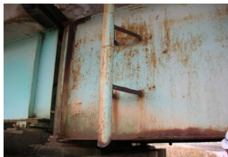
図-1.2 伸縮装置からの漏水による桁端部の腐食事例
