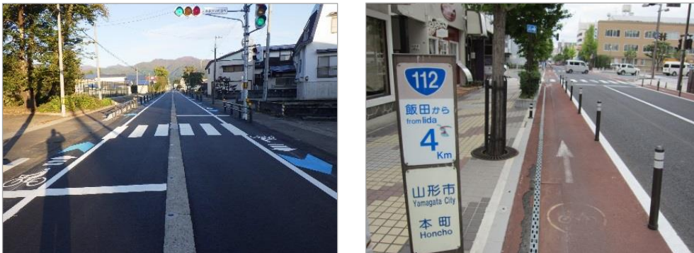
図 1-59 自転車通行空間の整備事例(左:車道混在、右:自転車専用通行帯)
