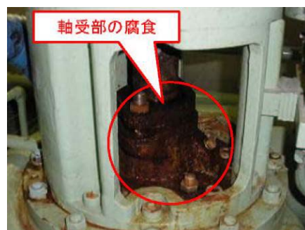
ポンプ設備の腐食
