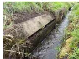
側壁が倒壊した排水路（村山市）
