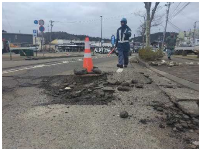
(令和 6 年能登半島地震による下水道マンホール浮上状況)
