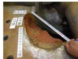
ポンプ内部の摩耗状況
