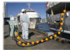
電力供給設備
