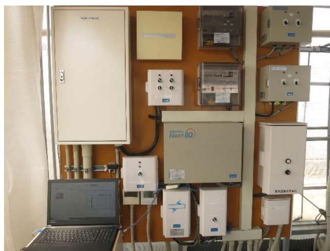
環境モニタリング、制御装置
