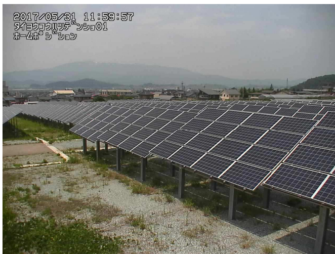
平成29年5月31日 12:00 太陽光発電所の状況
