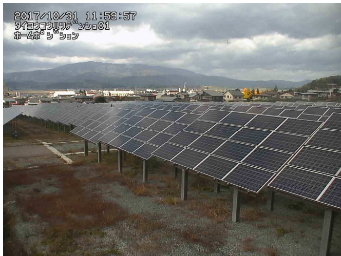
平成29年10月31日 12:00 太陽光発電所の状況
