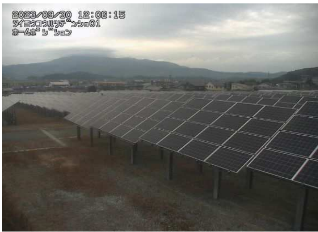
令和5年9月30日 12:06 太陽光発電所の状況
