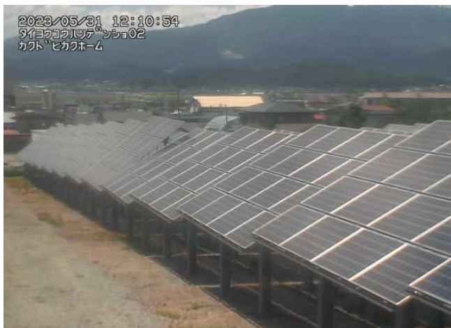
令和5年5月31日 12:10 太陽光発電所の状況
