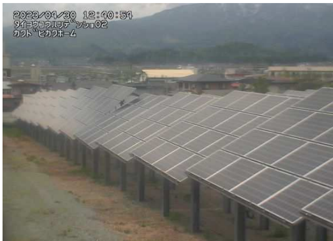
令和5年4月30日 12:40 太陽光発電所の状況
