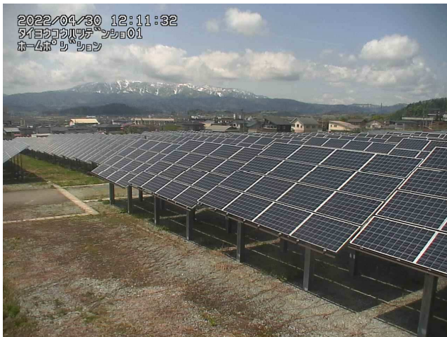
令和4年4月30日 12:11 太陽光発電所の状況
