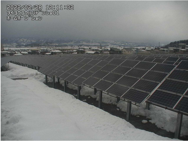
令和4年2月28日 12:11 太陽光発電所の状況
