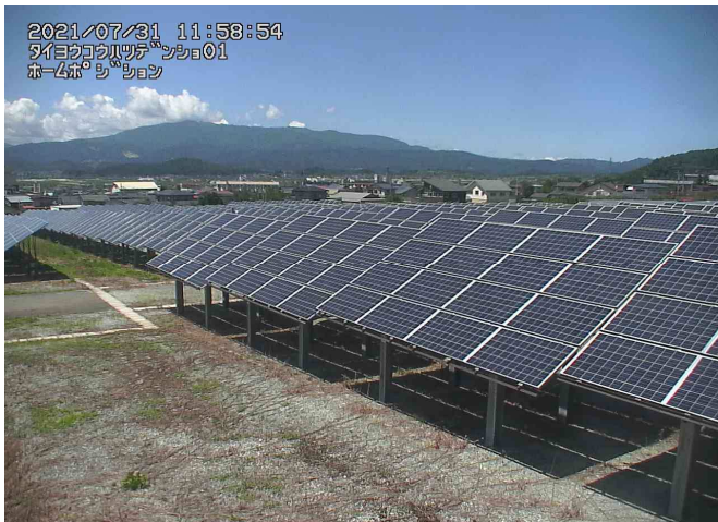
令和3年7月31日 12:00 太陽光発電所の状況
