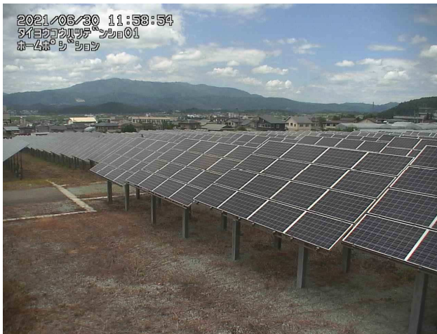
令和3年6月30日 12:00 太陽光発電所の状況
