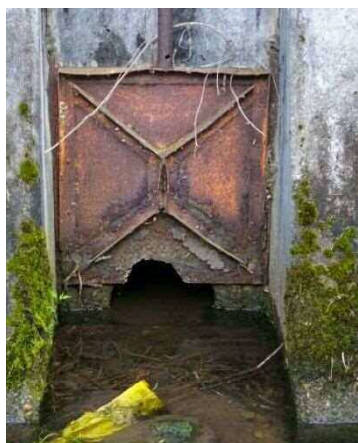
扉体に欠損があり 止水に影響がある
