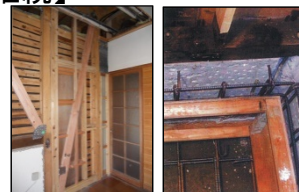
【減災・部分補強の例】 壁に筋交いを設置・RCによる基礎の補強
