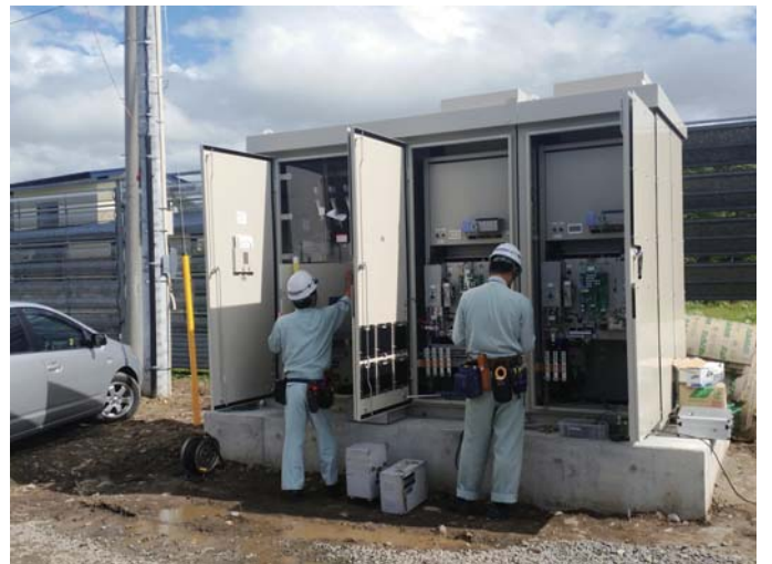
パワーコンディショナー&キュービクルの設備点検
